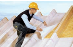
Instalación de barreras de vapor durante el saneamiento de tejados desde el exterior
